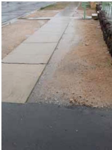
Diciembre 2008: el flujo del estacionamiento y callejón adyacente irriga la tierra y la guarnición en su camino hacia la calle.
